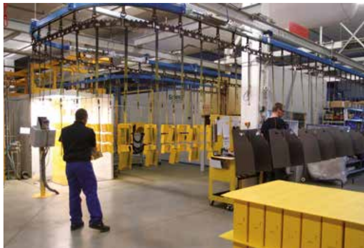
„Es soll die modernste, hochautomatisierte Lackieranlage in Westfrankreich sein“, behauptete 2014 der Vorlieferant. Flexibilität ist Trumpf. Kurze Rüstzeiten bei Farbwechsel.
